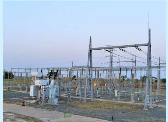
• Poste 225-30kV de Fatick
